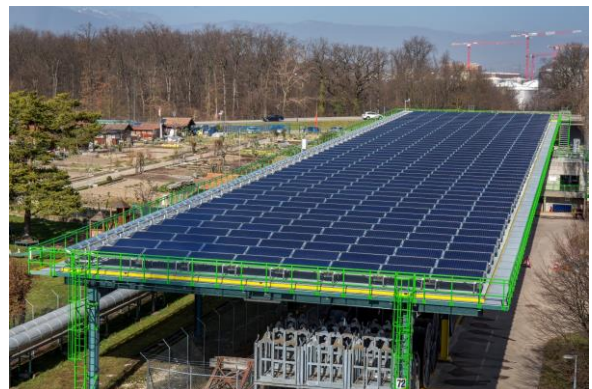
Abbildung 20: Gesamtansicht des SolarCAD II-Kraftwerks (Foto: Magali Girardin SIG)
