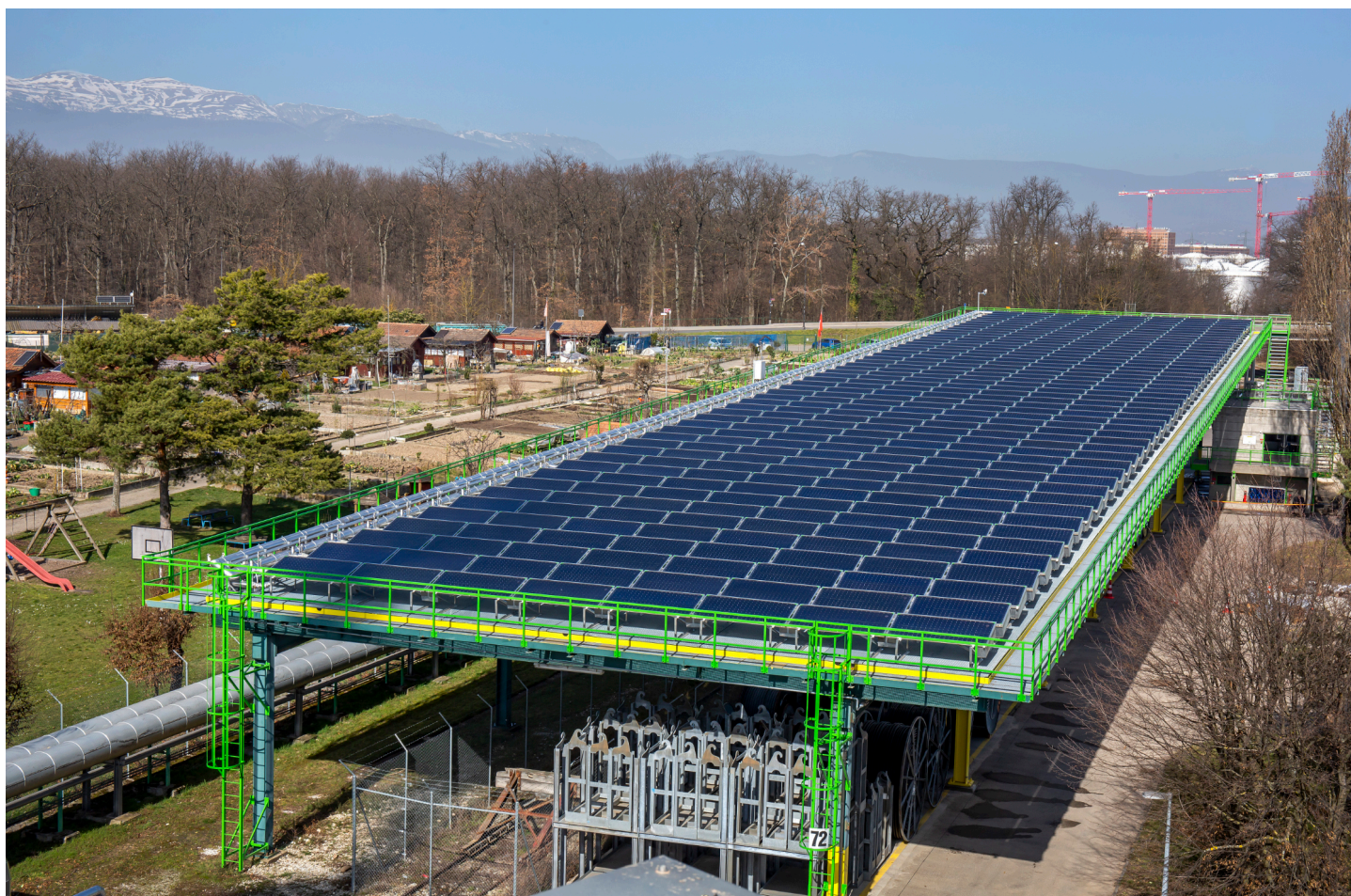
Eine 800 m 2 grosse Solarthermie-Anlage im Genfer Vorort-Quartier Le Lignon speist seit Dezember 2020 Warmwasser in das Genfer Fernwärmenetz ein. Foto: Magali Girardin / SIG
